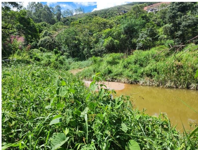
Figura 109: Registro fotográfico atual da Área de Intervenção 02, onde está instalada uma bacia de retenção de drenagem pluvial e contenção de sedimentos originados na cava, da área da UTM e em parte das estradas de serviço.
