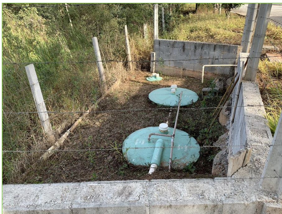
Figura 17: Estação de Tratamento de Esgoto Sanitário instalada no empreendimento da Lebourg.
