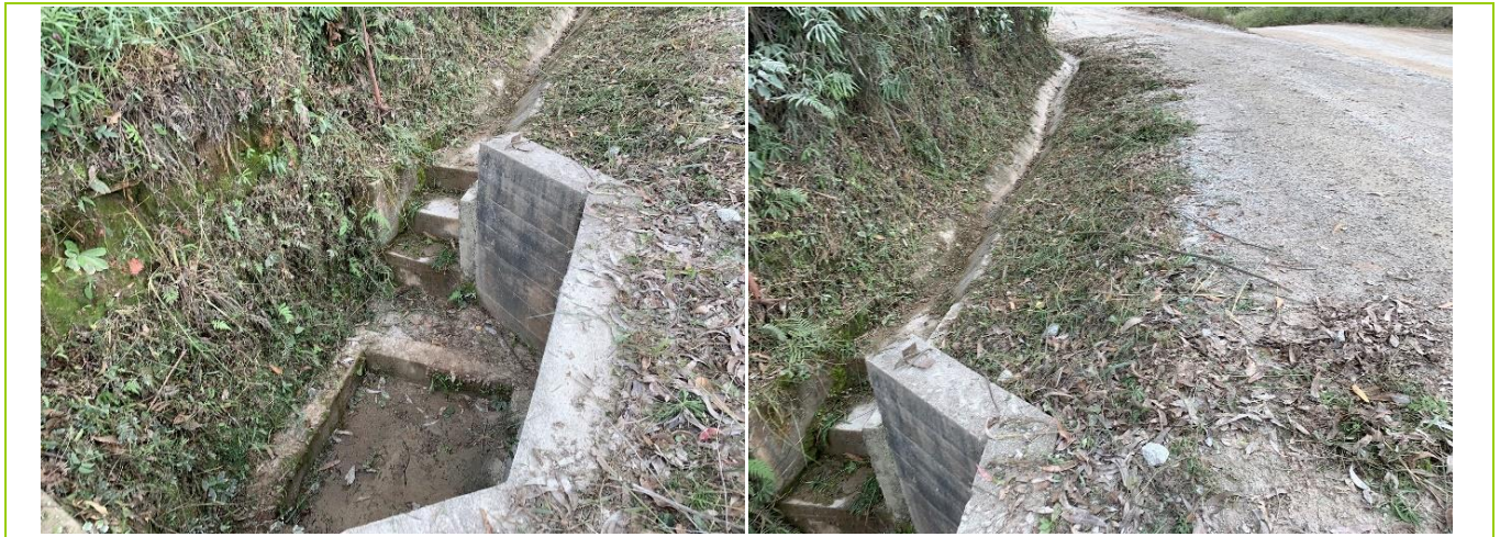
Figura 13: Exemplo das Canaletas de drenagem pluvial, com caixas de contenção de alvenaria instaladas nas laterais de uma das vias de acesso interno da empresa (via de acesso entre a área de lavra e área de abastecimento do britador primário).
