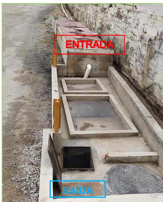
Figura 21: Sistema de tratamento de efluentes industriais (Caixa Separadora de Água e Óleo) do empreendimento.
