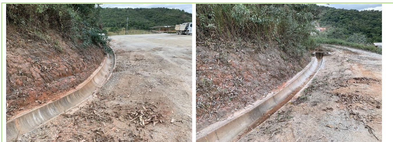
Figura 12: Exemplo das Caneletas de drenagem pluvial instaladas nas laterais de uma das vias de acesso interno da empresa (via próxima a área de abastecimento do britador primário).
