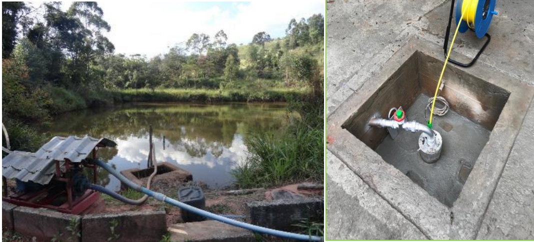
Figura 5: Reservatório formado a partir do barramento do Córrego A onde é realizado a captação e ilustração do poço tubular instalado na empresa.
