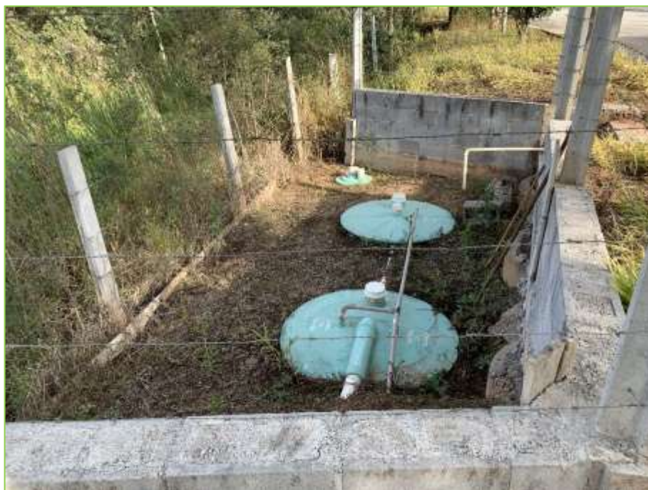
Figura 11: Estação de Tratamento de Esgoto Sanitário instalada no empreendimento da Lebourg.
