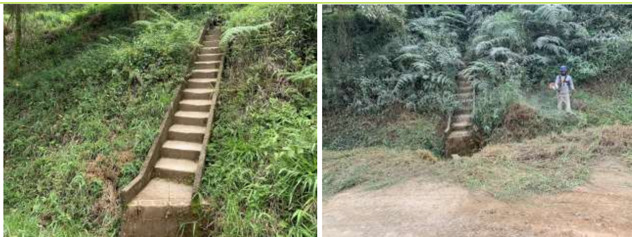
Figura 10: Exemplos de escadas hidráulicas, acompanhadas de bacia de contenção em alvenaria e manilha de passagem instalada nos taludes do imóvel.
