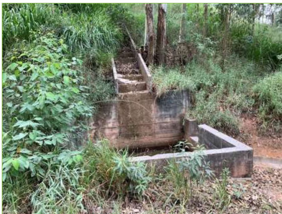
Figura 9: Exemplo de escada hidráulica instalada no talude da pilha de estéril reabilitada, com caixa de contenção de alvenaria e canaleta de drenagem.
