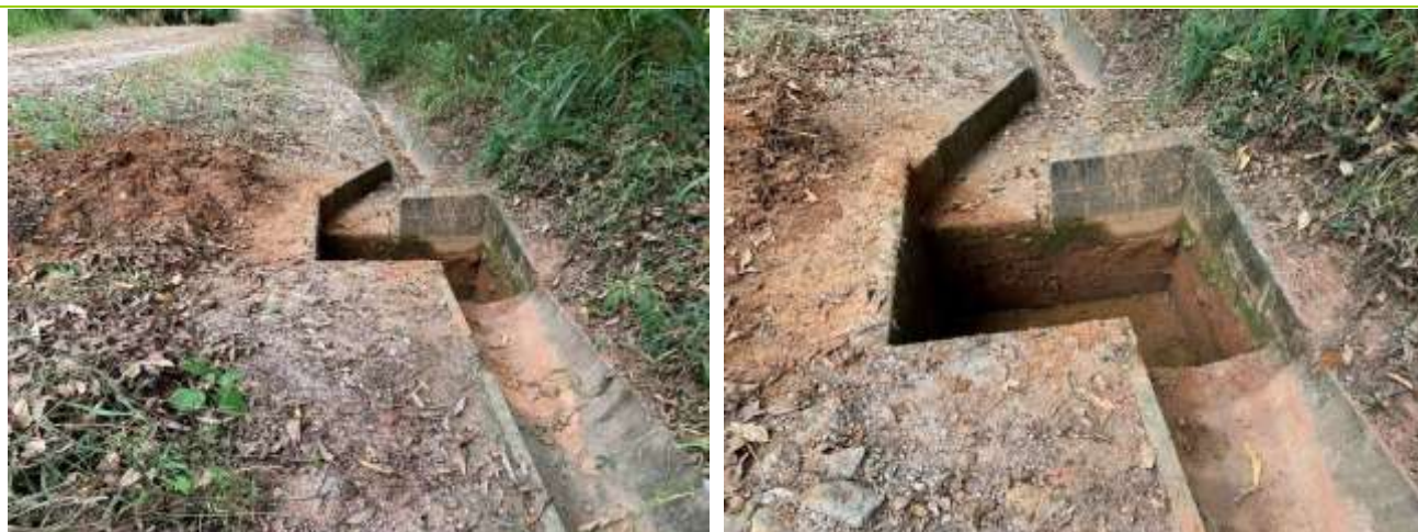
Figura 8: Exemplo das Canaletas de drenagem pluvial, com caixas de contenção de alvenaria instaladas nas laterais de uma das vias de acesso interno da empresa (via lateral da pilha de estéril desativada e reabilitada do empreendimento).
